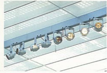
Hôtel de ville d'Eindhoven, Pays-Bas Architecte : Arie van Rangelrooy, En En Architecten, Eindhoven
